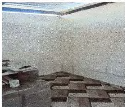
Foto 15: 21.2 Cernido en muro de la cocina escolar
